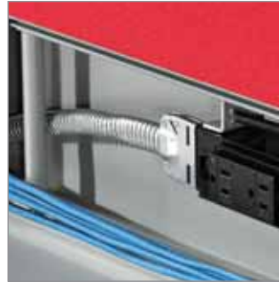
CANALISATION AU BAS DE LA CLOISON
