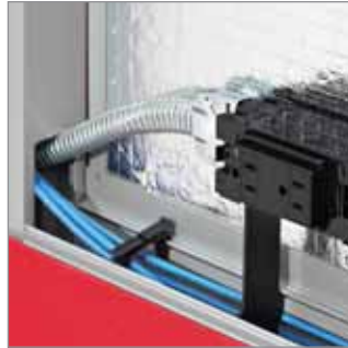
CANALISATION À LA HAUTEUR DU BUREAU (CLOISONS À OCULUS UNIQUEMENT)
